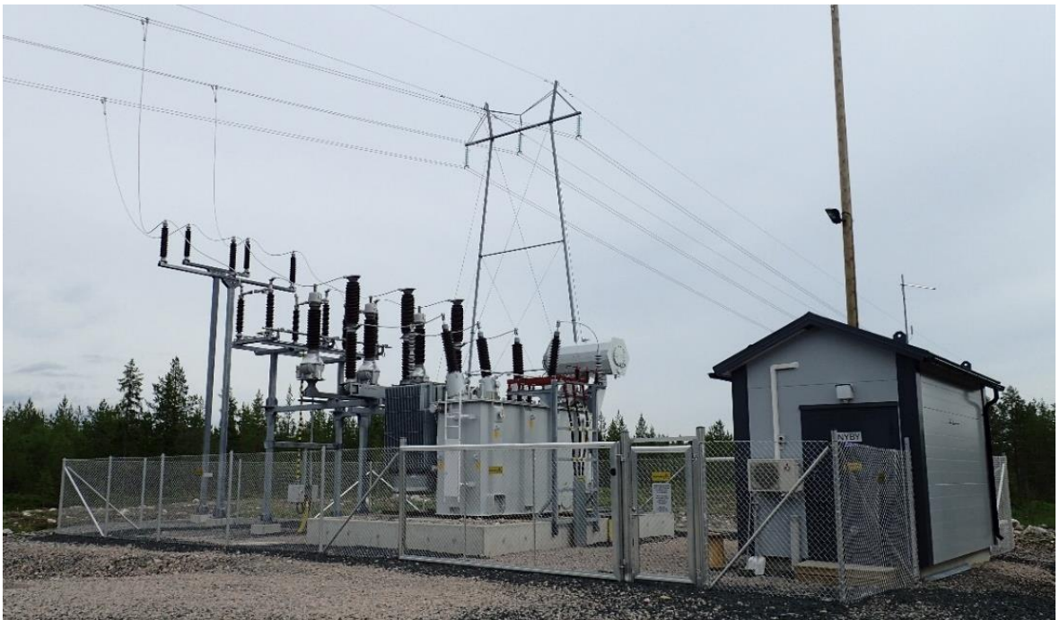
Kuva 16. Esimerkki tuulivoimapuiston sähköasemasta.
