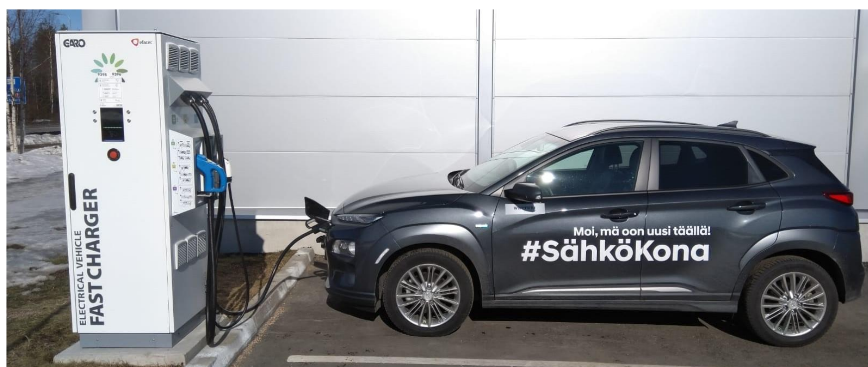
KUVA 1. Hyundai Kona latauksessa Garon valmistamassa ja Virran hallinnoimassa latausyksikössä
