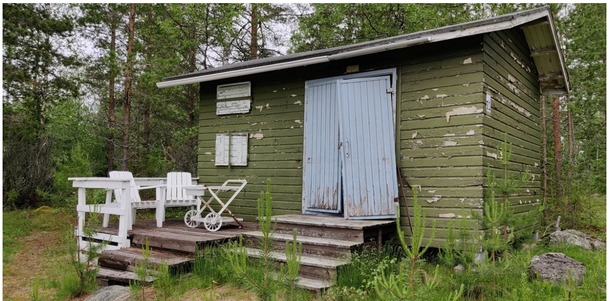
Kuva 14. Asemakaava-alueella sijaitseva purkukuntoinen lomarakennus. Kuva: Minna Takalo 28.06.2021.
